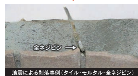
地震による剥落事例 (タイル・モルタル・全ネジピン)
