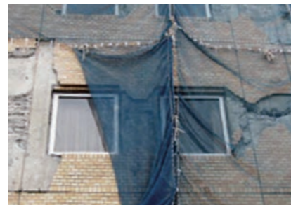
東日本大震災の被害状況【写真1】
