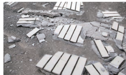
高所から落下した外壁【写真5】
