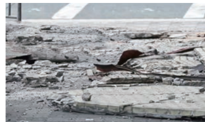
高所から落下した外壁【写真4】
