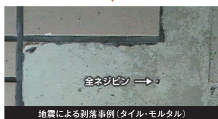
地震による剥落事例 (タイル・モルタル)
