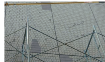
建物外壁の損傷事例【写真3】
