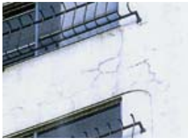
外壁のひび割れ
