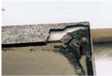
モルタルの欠損
