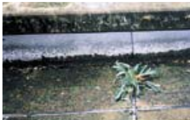
屋上防水の劣化
