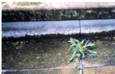
屋上防水の劣化
