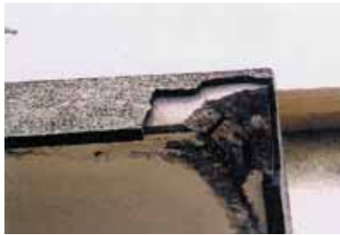
モルタルの欠損
