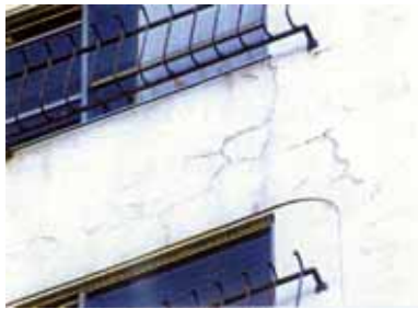
外壁のひび割れ
