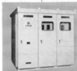
屋外キュービクル
