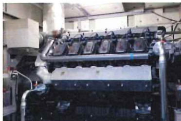
コジェネレーションシステム
