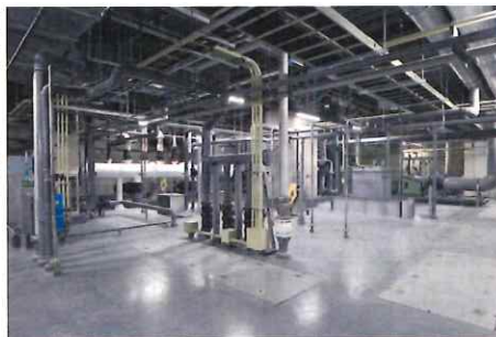
汚水の浄化施設
