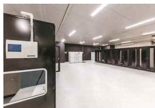
データセンター実験室
