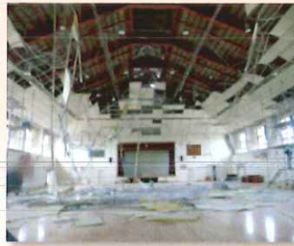
体育館における天井落下例
