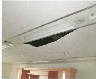
ライン天井の落下例
