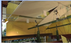
無補強：多くの天井ボードが落下
