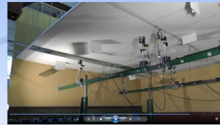
補強：ボードの落下はなく、損傷もほぼ無し
